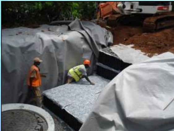
Réalisation d'un bassin d'infiltration sous espace vert pour le projet des 6 logements du vice rectorat de Mamoudzou (architecte : JVO3 – conception : MBE)
